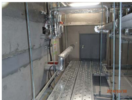
▲現場写真 天井内メンテナンス歩廊
