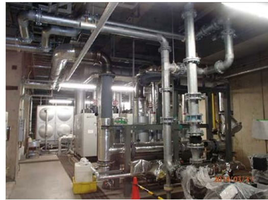
▲現場写真 ボイラ機器廻り
